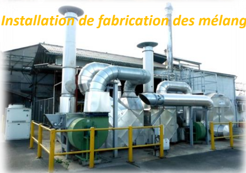
Traitement des gaz
